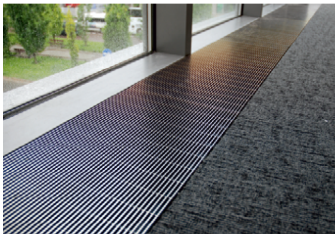
Grilles de chauffage encastré
