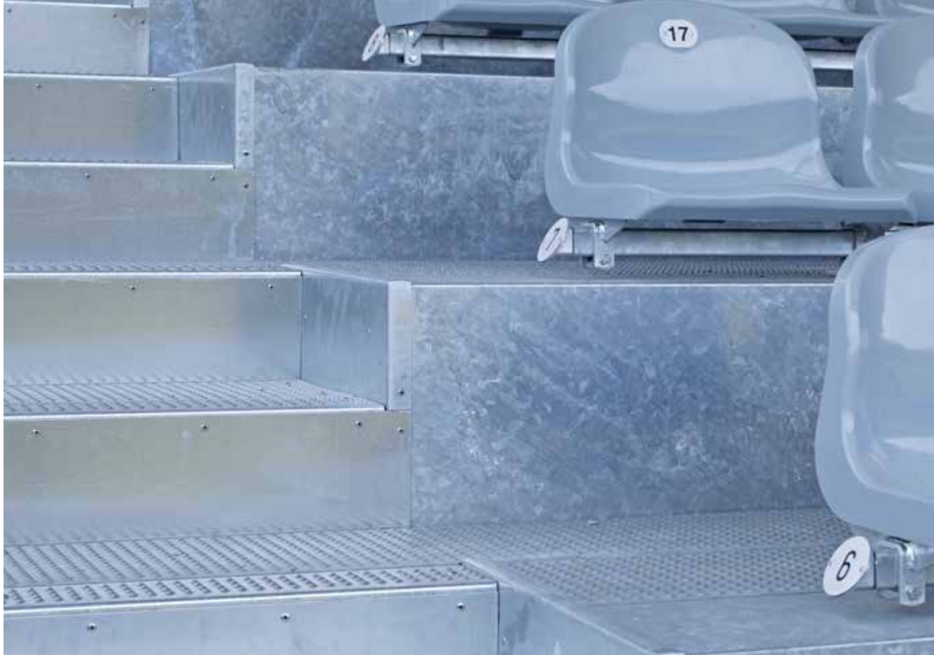
Im Tribünenbereich des Poststadions in Berlin werden MEISER Blechprofilroste in der Variante Bostep G als Bodenbelag eingesetzt
