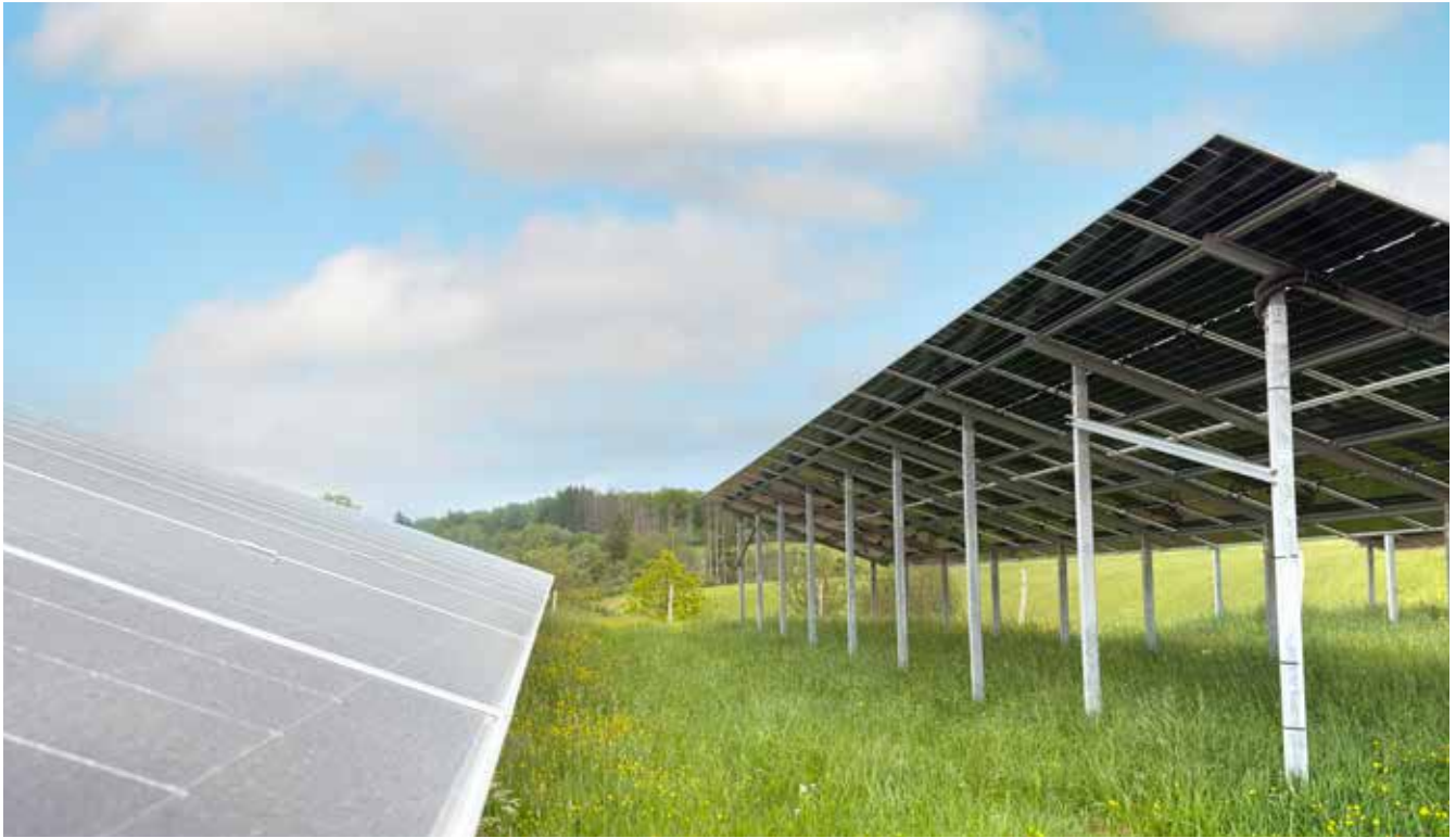
Das Zweifuß-Montagesystem MEISER Portrait in einem Solarpark in Nonnweiler
