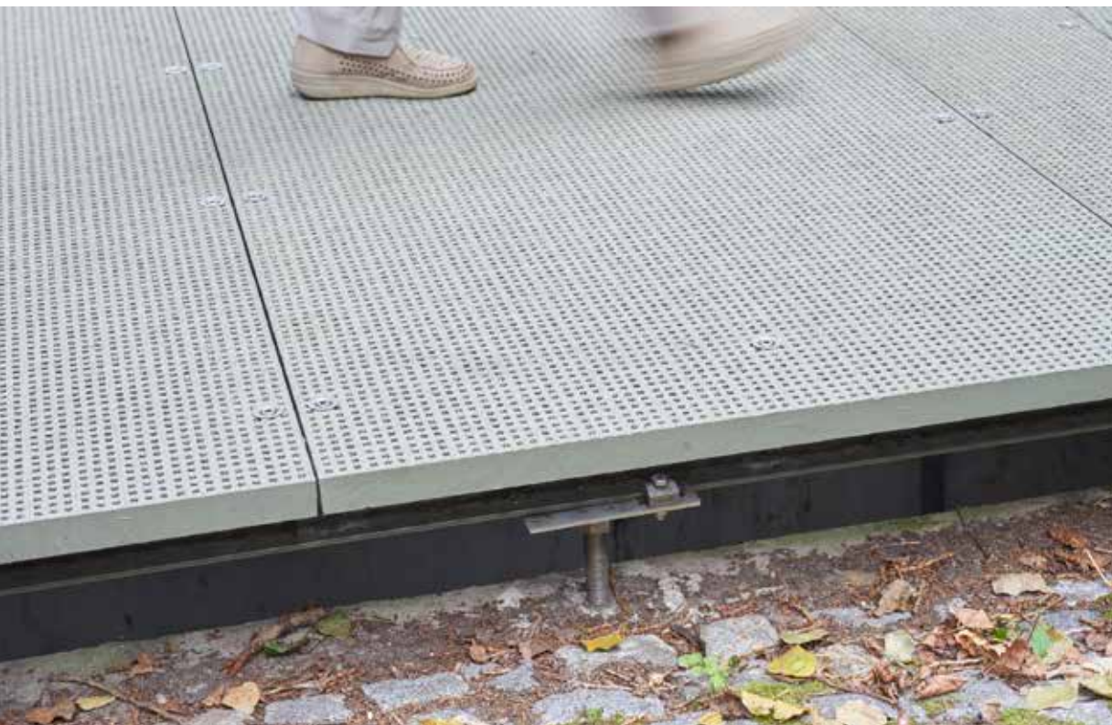
Die gegossenen GFK-Roste dienen auch als komfortabler Fußweg
