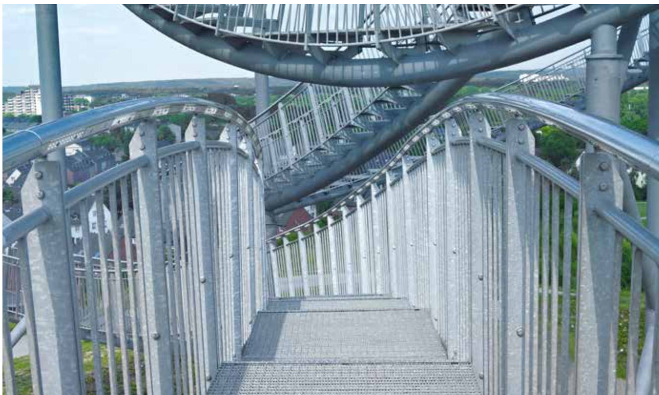
Auf der begehbaren Achterbahn Tiger & Turtle bieten MEISER Pressroste mit Gleitschutz sicheren Tritt in luftiger Höhe
