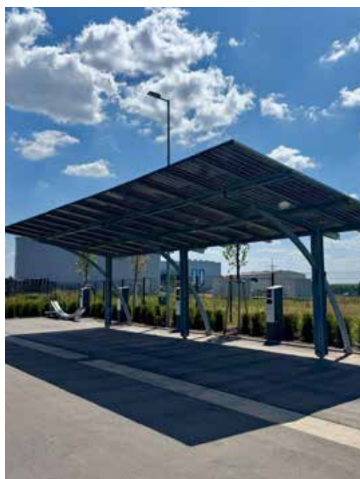
Le VOLTWING ECO sur le site de MEISER Solar à Losheim am See
